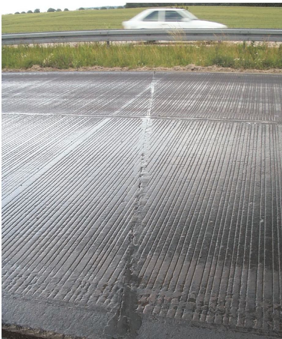
Figur 1. Betonoverfladen med fuge. Der var fræset tværgående riller for at øge friktionen. Overfladen er her påsprøjtet special klæbeemulsion Colacid B umiddelbart inden udlægningen af Combifalt 8.
