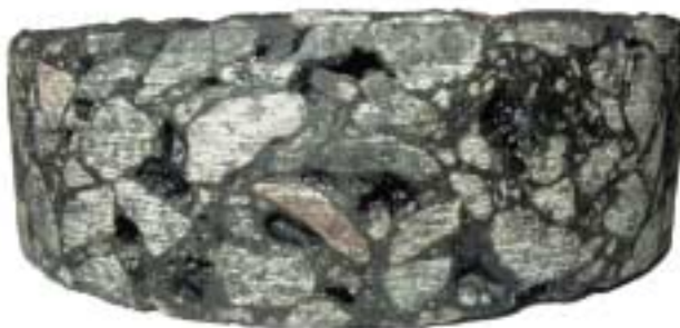
Figur 1. Borekerne fra forseglet AB 12å. Forseglingsemulsionen er trængt ned hulrummene i belægningen.
